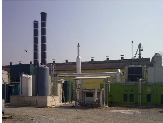
Figura 8.2: Impianto di essiccazione con scrubber acido (Foto CRPA)
