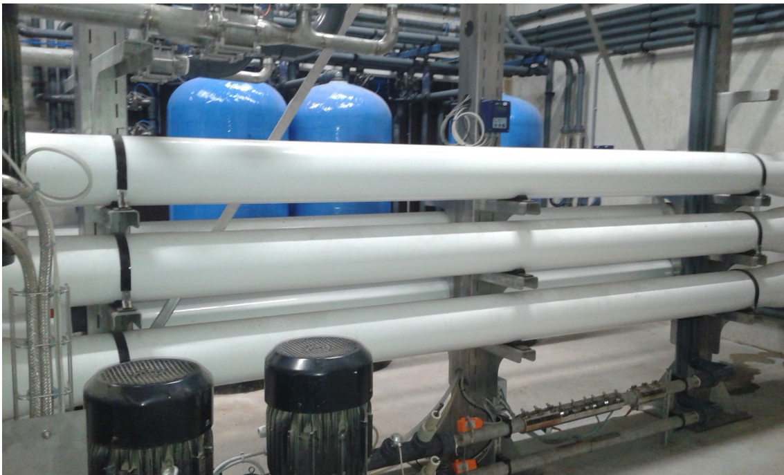
Figura 3.2: impianto UF+OI su digestato da effluenti zootecnici in Olanda.
