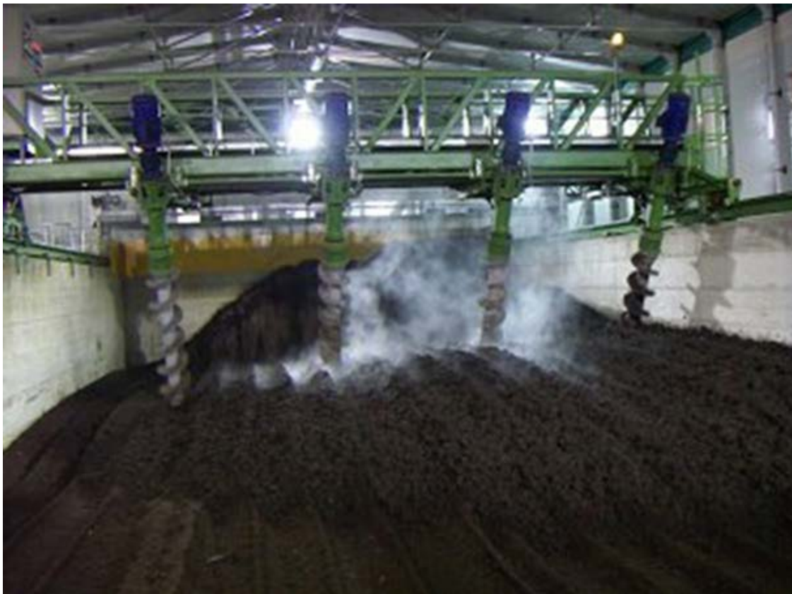
Figura 7.2: impianto di compostaggio su frazione solida di digestato
