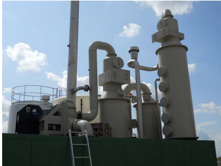
Figura 4.2: Impianto di strippaggio e colonne per l'assorbimento dell'azoto ammoniacale
