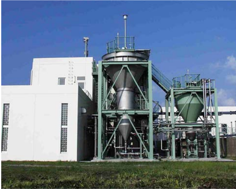
Figura 2.2: Veduta del reattore di precipitazione Struvite nell'impianto di depurazione delle acque reflue della Prefettura di Shimane Lake Shinji East, Unitika, Giappone
