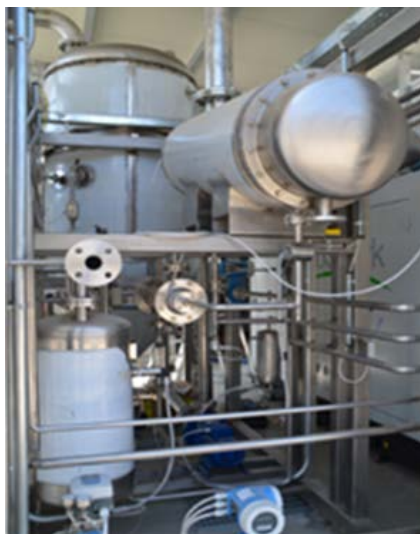
Figura 8.5: Impianto di evaporazione sottovuoto
