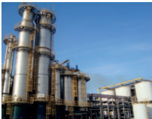
Figura 40: impianto a bioetanolo a Sullana (Perù) 151
